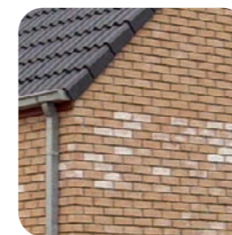
Efflorescence de sel
