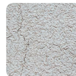
Fissures capillaires/de vent
