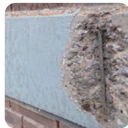
Carbonatation du béton
